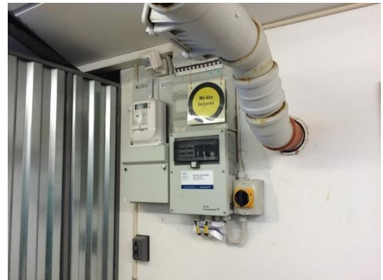
| Styring til pumpe.
