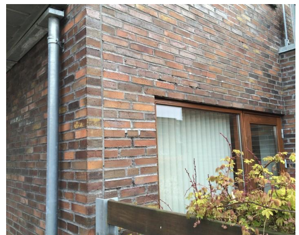
| Skader ved nr. 66.
