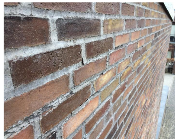
| Skademe ved gavlen.
